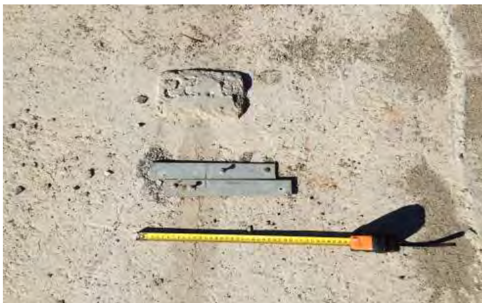
Рис. 1. Трещина в фундаментной плите специальных объектов (маяк над трещиной)
