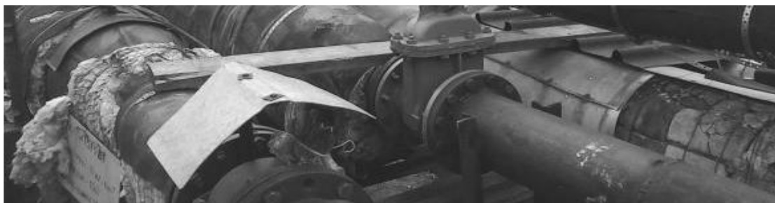
Рис. 1. Разрушение тепловой изоляции на трубопроводах тепловой сети
